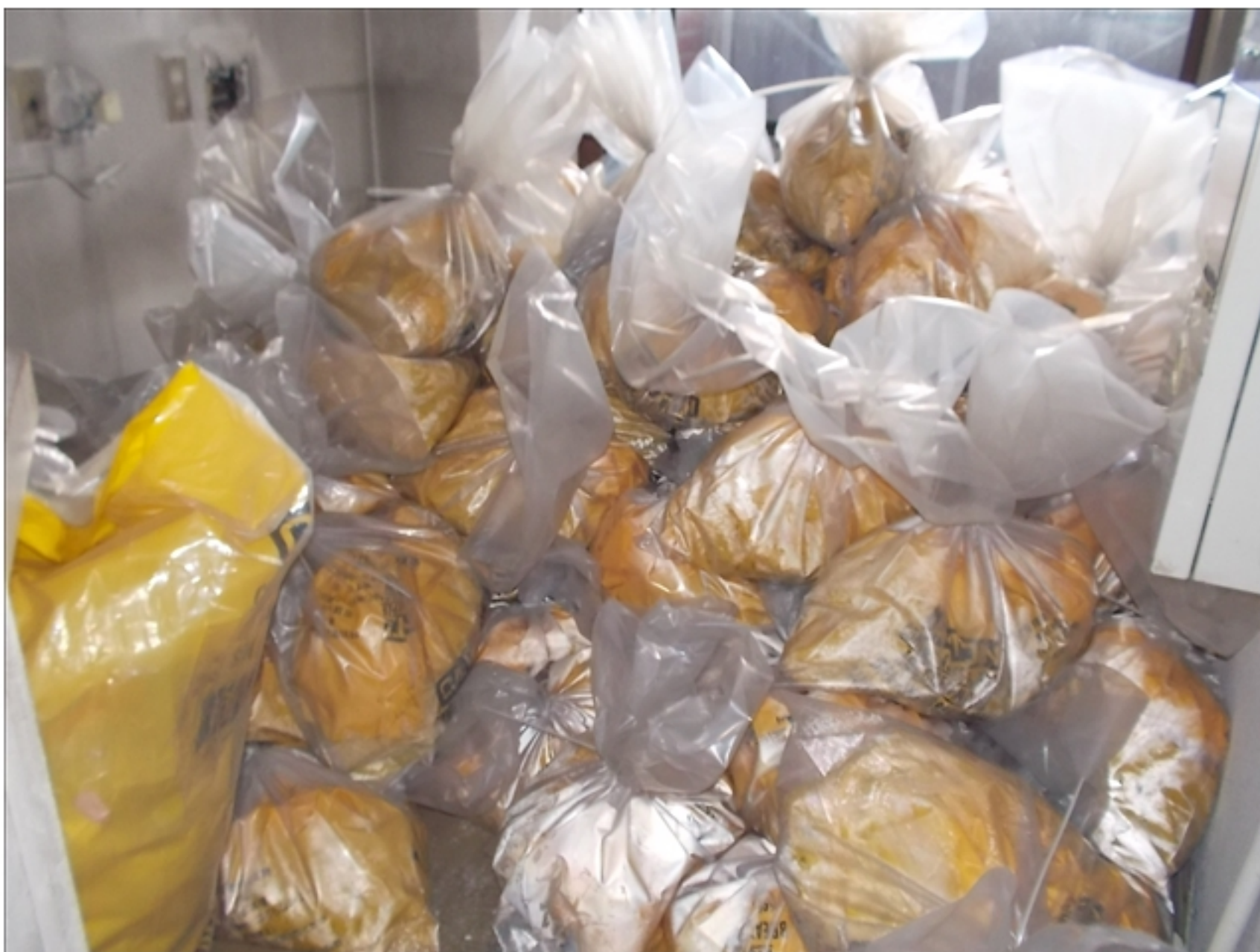
工事種目：アスベスト保管状況
